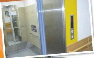
エレベーター
