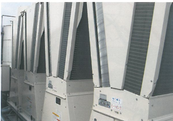
室外ユニット
